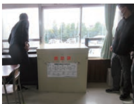
▲ 救助袋設備設置場所
