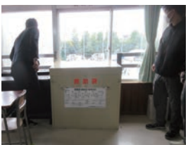
▲ 救助袋設備設置場所
